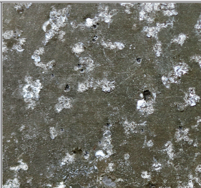
Detalles de la corrosión superficial
